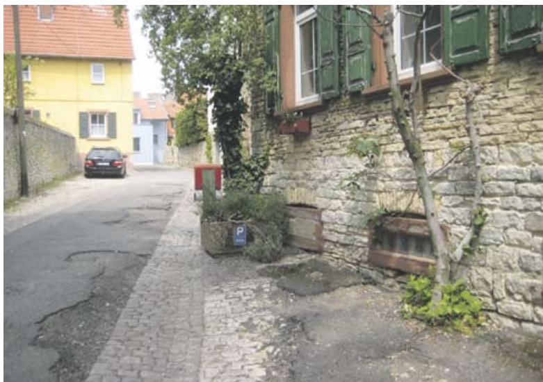
Vorher: Wirklich in einem sehr sanierungsbedürftigen Zustand präsentierten sich einige Sträßchen vor der Sanierung im Ortskern von Dalsheim.
